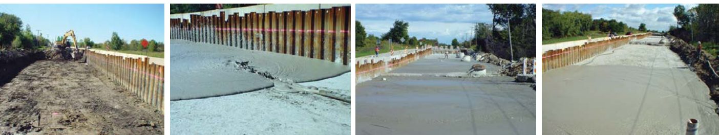
Fot. 3. Zastosowanie pianobetonu przy przebudowie Central Road [33]; widok „dwustopniowego” projektu wypełnienia dróg, w którym na pierwszym planie jest zainstalowana stalowa blacha w osi drogi w celu podtrzymania ruchu pojazdów, podczas gdy wykopywanie, układanie pianobetonu i kolejnych warstw nawierzchni mogą odbywać się w pierwszym etapie [23]
