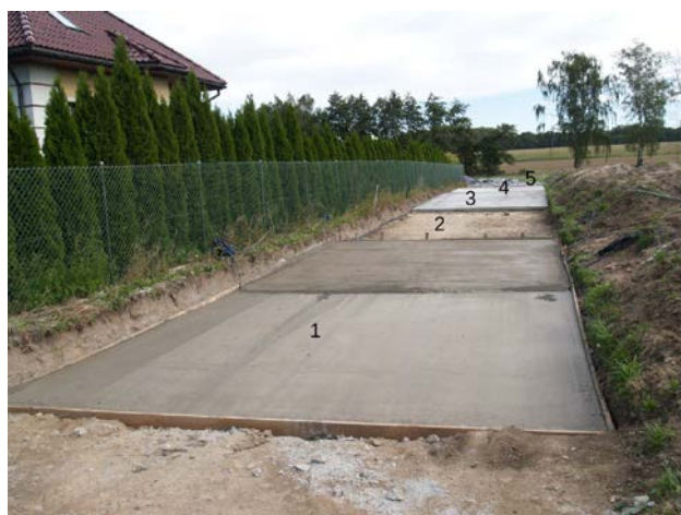
Rys. 2. poligon doświadczalny z podziałem na odcinki na etapie w budowywania pianobetonu w warstwę podbudowy pomocniczej
